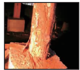
●白アリの被害を受けた束柱
